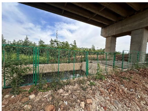
S228 新河大桥事故应急池
