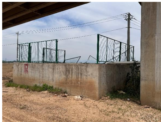
复东村桥事故应急池
