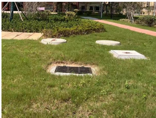
桐心家园化粪池
