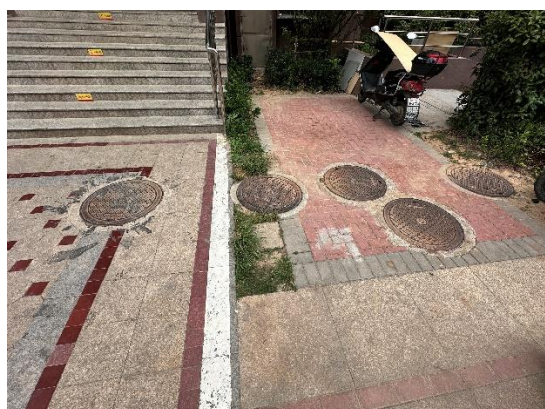
申山安置点 1 期化粪池
