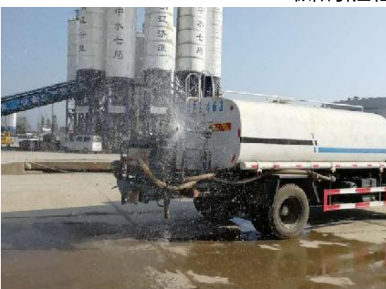
混凝土拌合站
