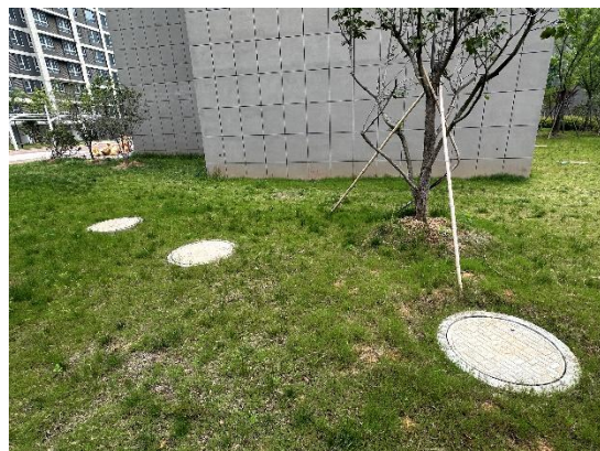
申山安置点 2 期化粪池
