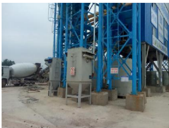
混凝土拌合站
