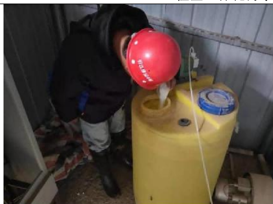
一体化生活污水处理设施添加消毒剂
