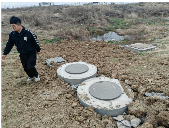
白山节制闸化粪池
