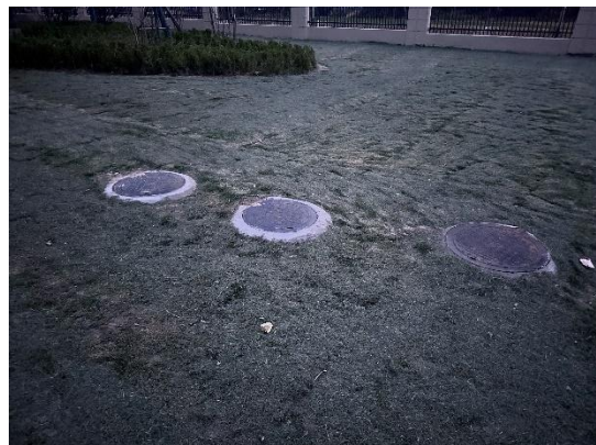
小墩安置点化粪池
