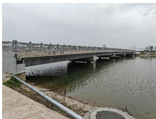
北闸生产桥径流收集管
