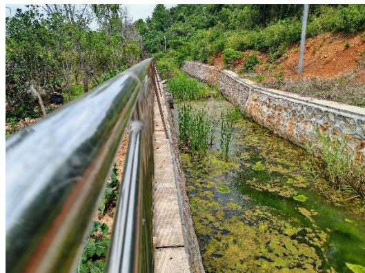
晴岚家园生活污水存在直排情况
